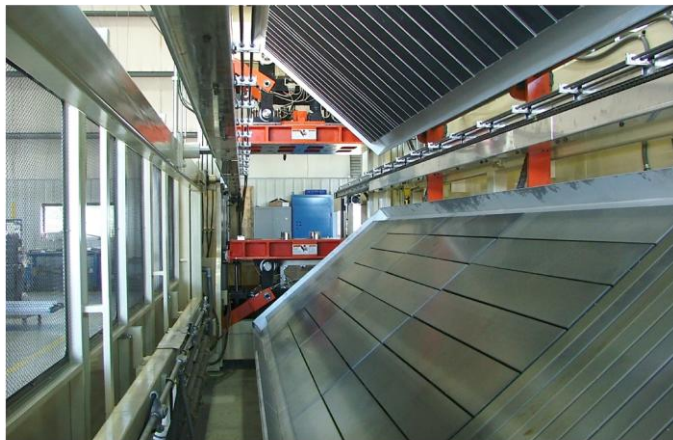
Батарея панельных нагревателей печи
